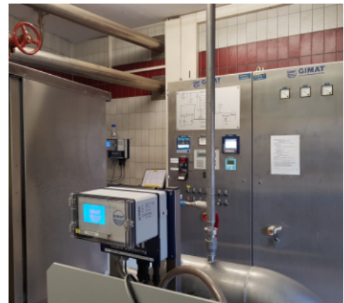
Technikraum der Bischoff-Kläranlage
