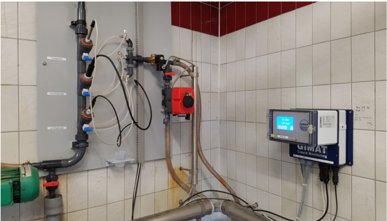
Controller (rechts), Messstrecke mit Sensoren (links) und Spülvorrichtung (mitte), eingepasst in vorhandene Leitungen
